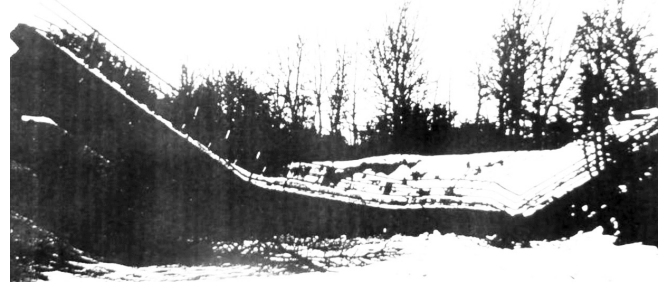
Rys. 4. Zniszczony most drogowy w Osobnicy k. Jasła
