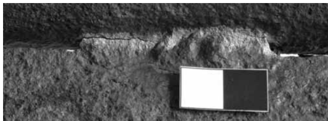
Rys. 8. Pęknięcie w górnym złączeniu spawanym literą R z rurą w wyrazie FREI
