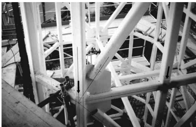
Rys. 3. Spoiny czołowe styku warsztatowego na wysokości 6,1 m Fig. 3. Workshop contact butt welds at the high of 6.1 m
