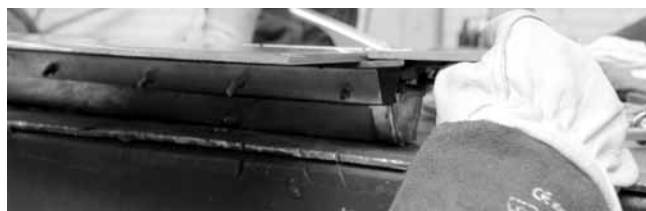
Rys. 9. Niepełne przyleganie podkładki osłaniającej grani
