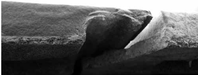
Rys. 2. Odłamane naroże dachówki otwiera drogę dla wody do wnętrza dachu Fig. 2. Chipped corner of the roof tile opens the way for water to the roof interior
