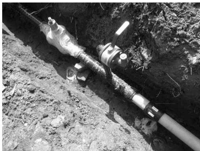
Rys. 11. Zespół zaporowo-upustowy z zasuwą odcinającą Fig. 11. Blocking – venting set with a blocking bolt
